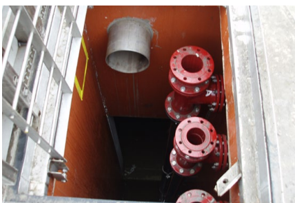
BKU I PVC T-grip in rioolgemaal
