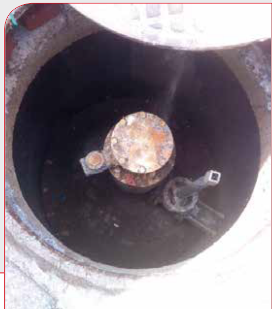
Das bei der Gemeinde Rotterdam eingebaute Gerät läuft bereits seit 13 Jahren
